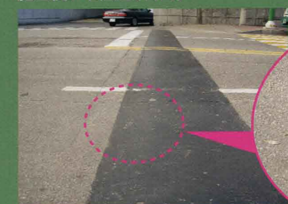
施工後7年経過(韓国)
